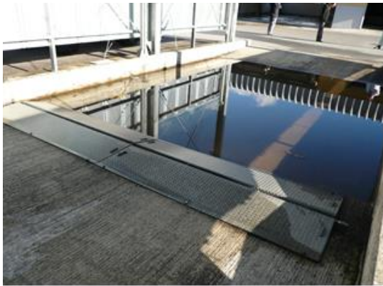
車両消毒設備
