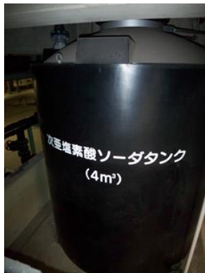
放流水の毒薬タンク
