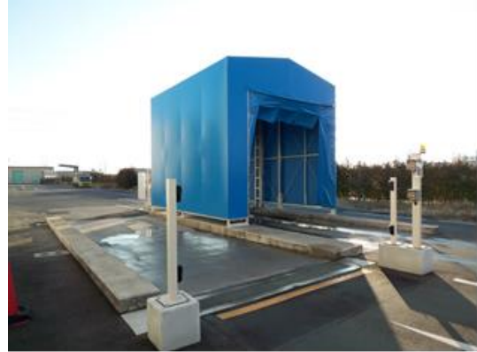
生体搬入車両消毒設備
