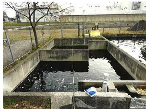
放流水の消毒槽
