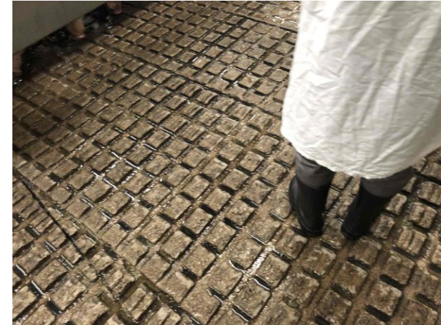
けい留所の床の滑り止め
