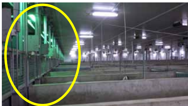
写真17 誘導路の照明
