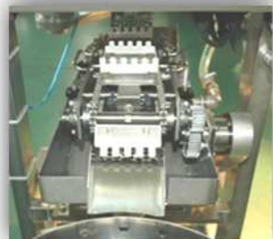
洗浄部(裏側より)
